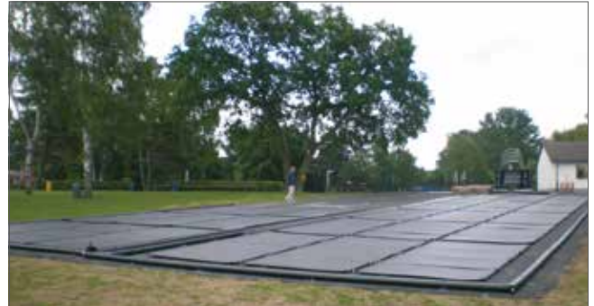
Freiflächenmontage Freibad Wehrheim
